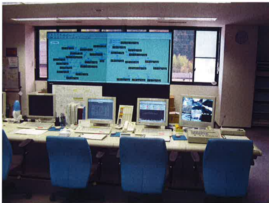
杣口浄水場中央監視室
