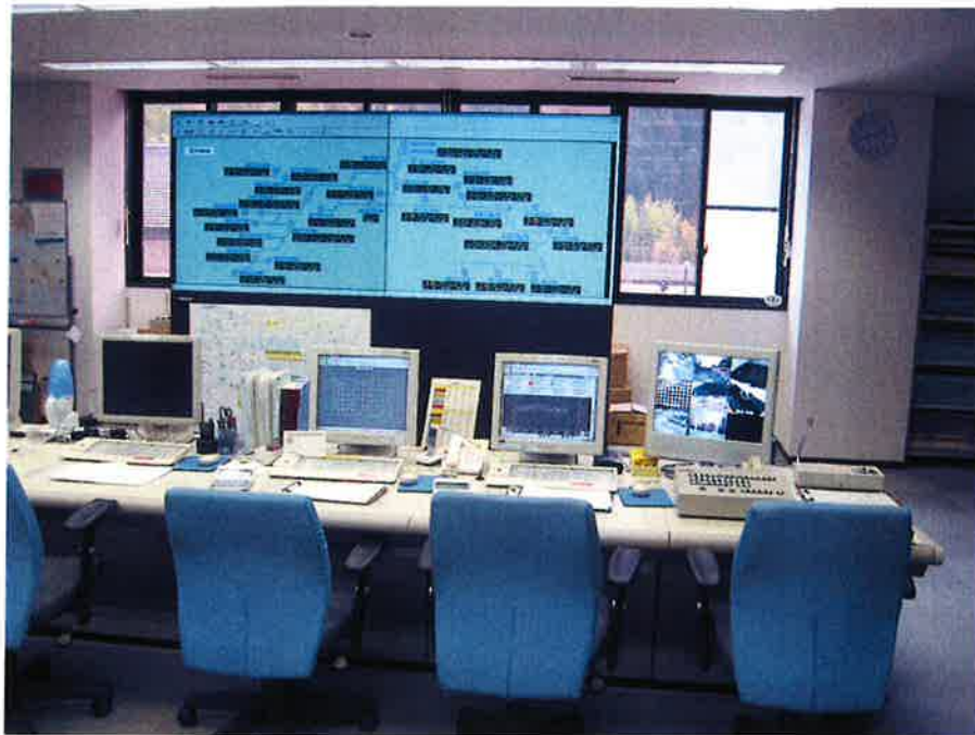
柚口浄水場中央監視室
