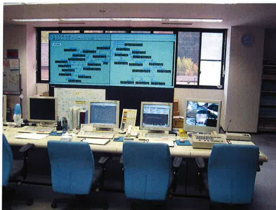
杣口浄水場中央監視室
